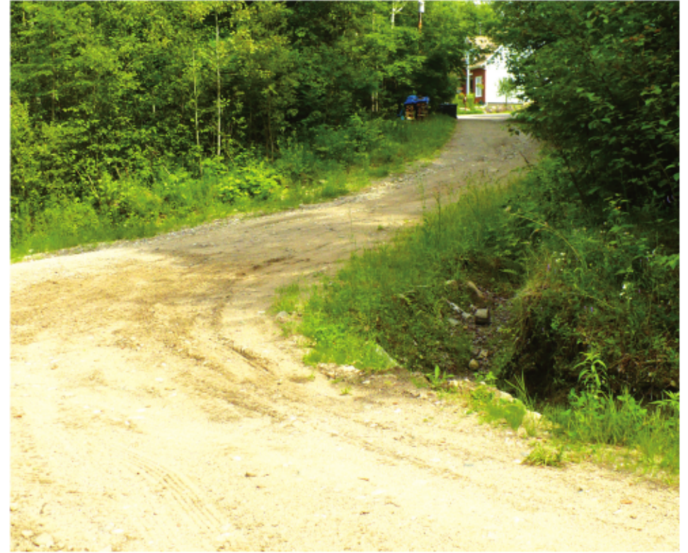
Si on n'y prête pas attention, notre entrée et ses fossés peuvent acheminer une quantité considérable de sédiments jusque dans un cours d'eau, ce qui représente une source importante de pollution. (Crédit : COBALI)
